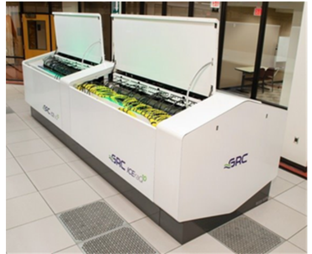
写真： 液浸冷却ラック（サーバーが入った油槽）
